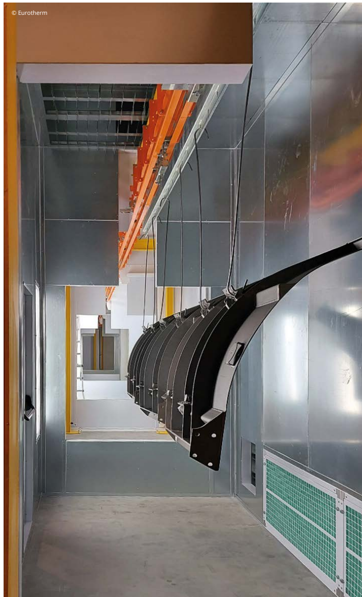
Il tunnel di flash-off.
