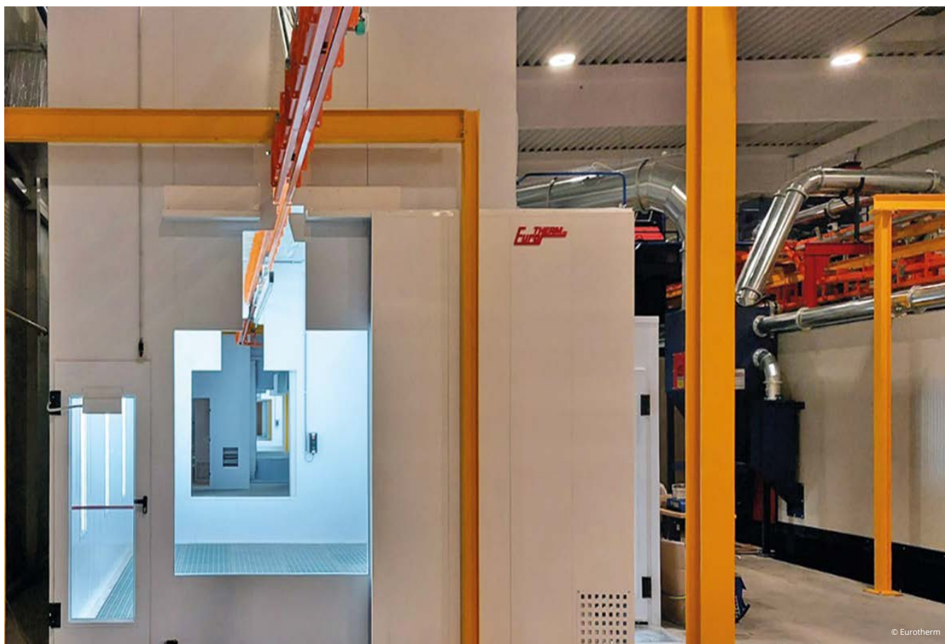
Una delle due cabine di verniciatura pressurizzate.
