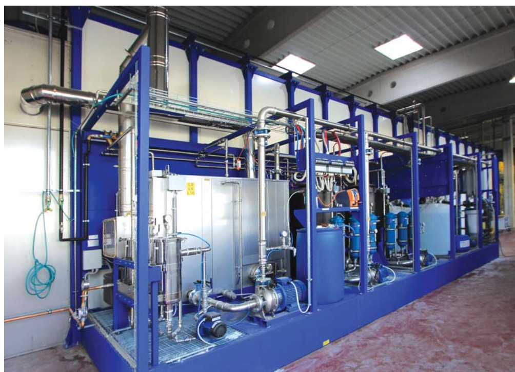
Lo skid per il recupero e la filtrazione delle acque di lavaggio.
