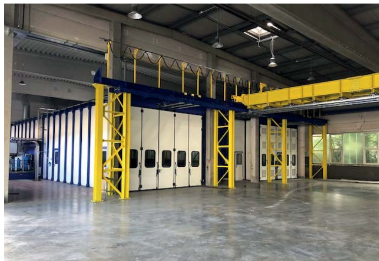
Il nuovo impianto installato da Eurotherm Spa.
