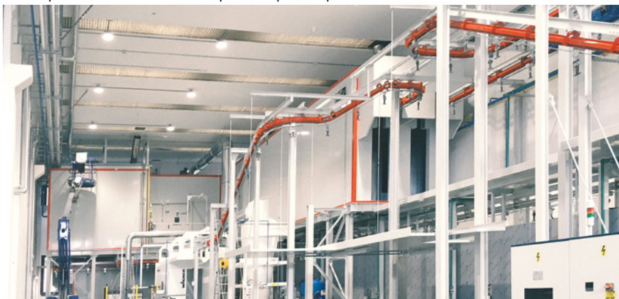
➤ Impianto di verniciatura a polvere in continuo
