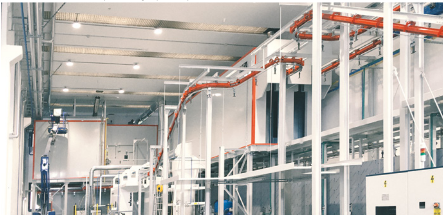
➤ Installation de poudrage en continu
