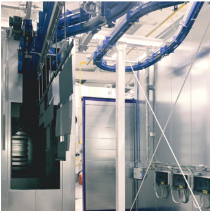
➤ Installations de poudrage pas à pas
