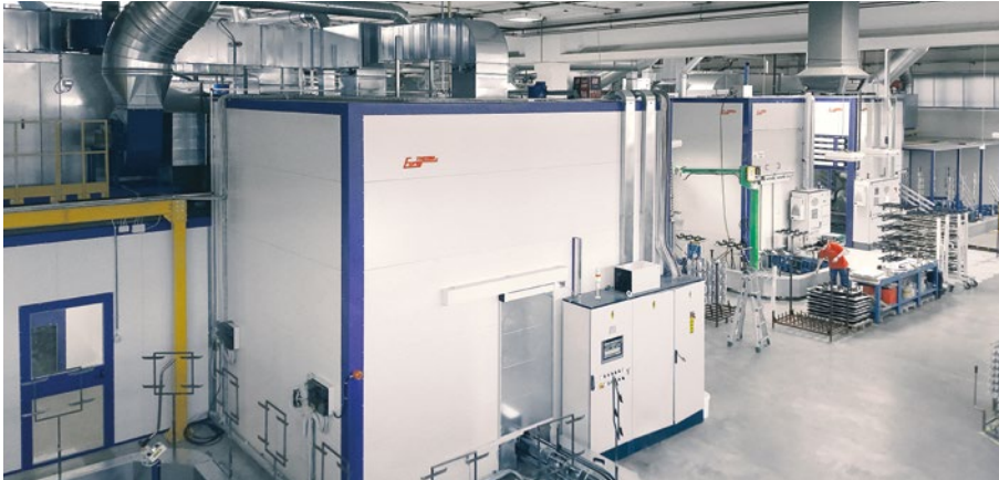
➤ Automatische Step by step Nasslackieranlage mit Bodenförderer
